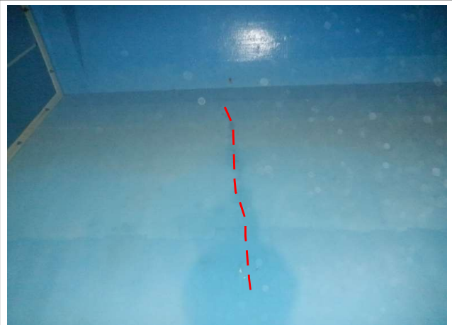
배수지1지 벽체 균열(0.3mm미만)
