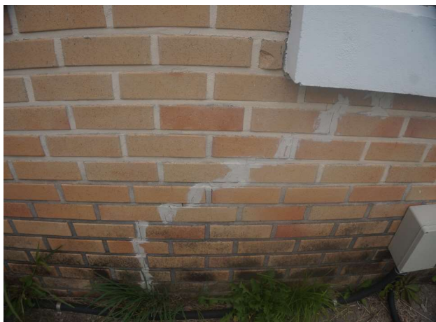
통합검수실 외부벽체 계단식 균열
