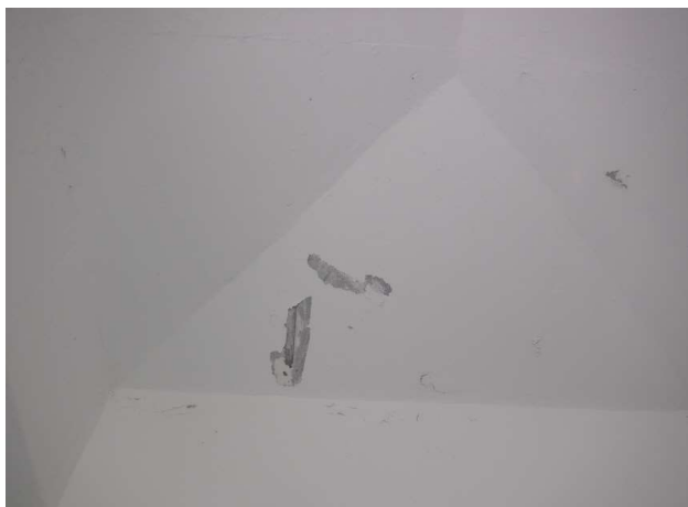
검수실 내부 상부슬래브 도장박리
