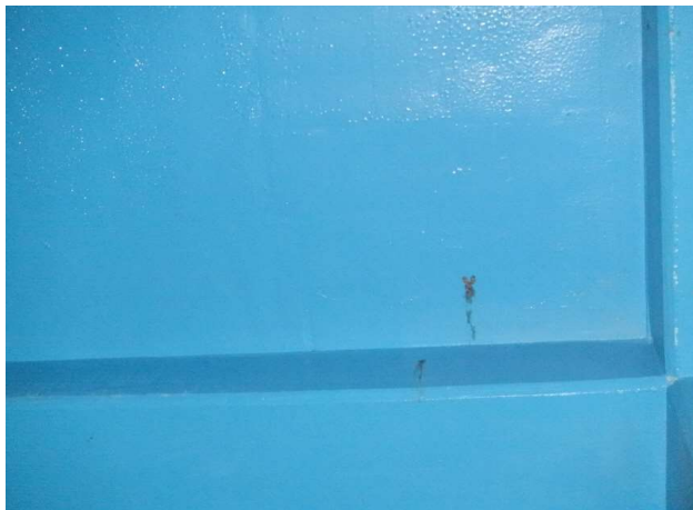
배수지1지 상부슬래브 녹물
