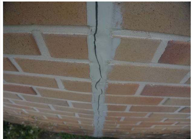
통합검수실 시공이음부 파손
