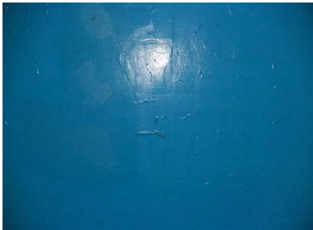
배수지2지 상부슬래브 도막박리
