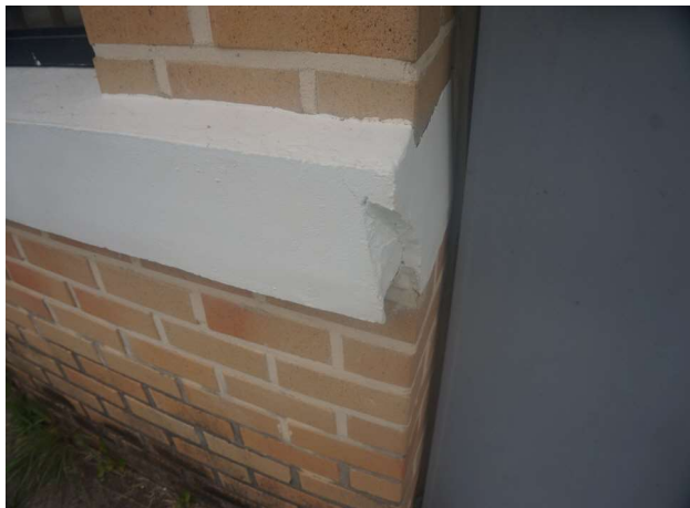
통합검수실 외부 모르타르 파손
