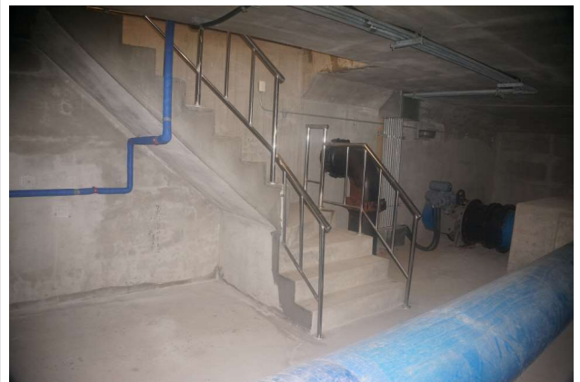
밸브실 안전난간 상태양호
