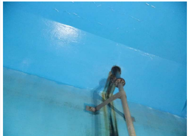
배수지2지 상부슬래브 누수흔적
