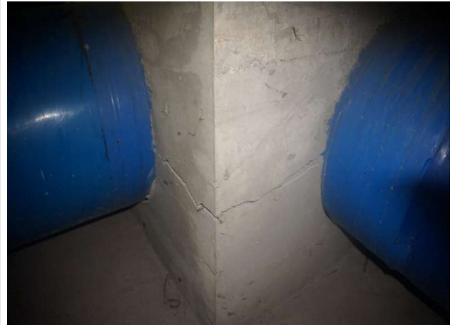
유입밸브실 베드 파손
