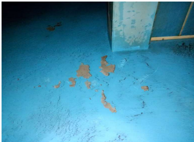
배수지2지 하부슬래브 도막박리
