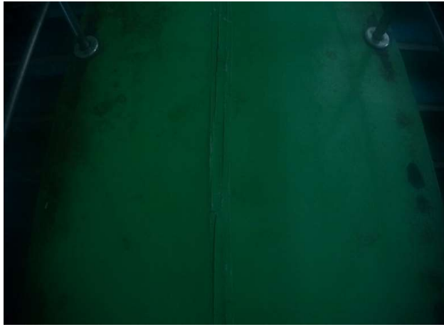
통합검수실 내부바닥슬래브 실링재 균열
