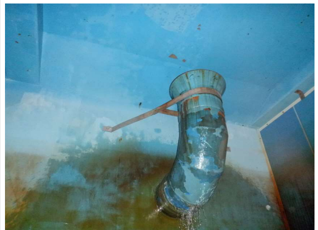
배수지 2지 유입배관 관부식
