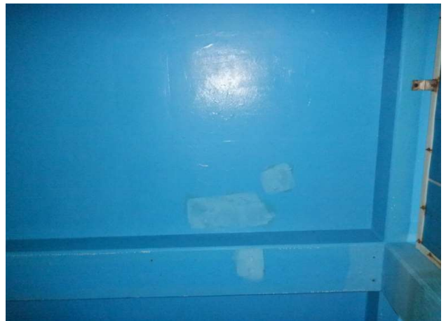
배수지1지 상부슬래브 도막박리
