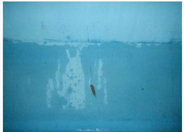
배수지2지 벽체 도막박리/균열
