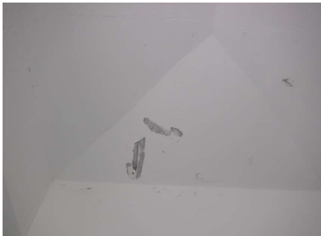
검수실 내부 상부슬래브 도장박리
