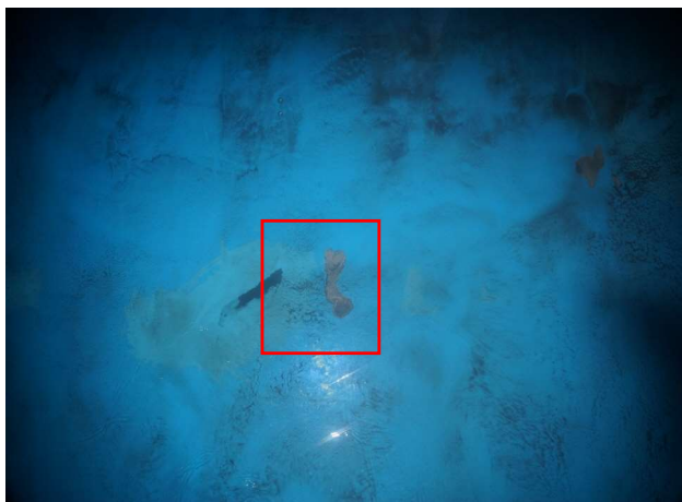
배수지1지 하부슬래브 도막박리
